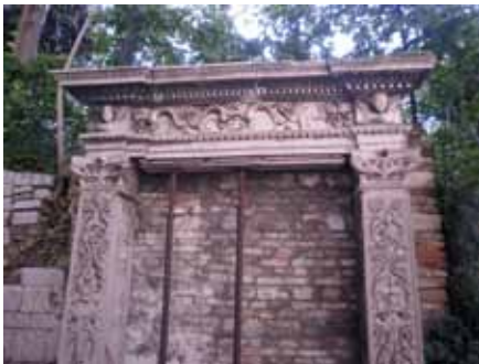
Fig. 1 - Portale lapideo prima del restauro
