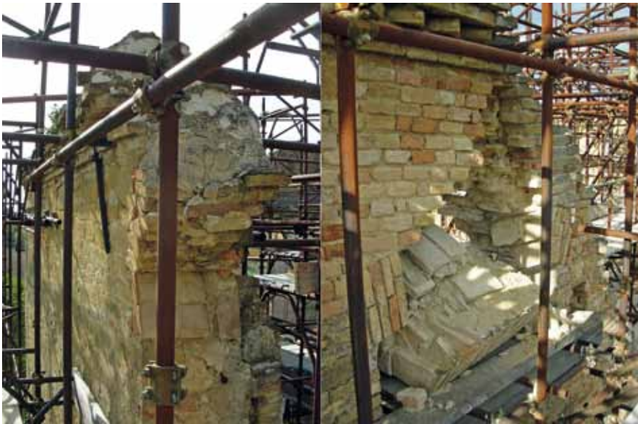
Fig. 9 - Muratura sommitale - cedimenti e deformazioni
