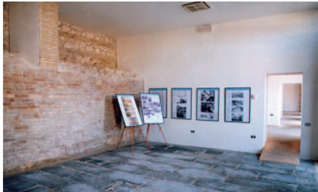
Fig. 20 - Ex Scuola Marinara - interno dopo dell'intervento di restauro con la pavimentazione restaurata
