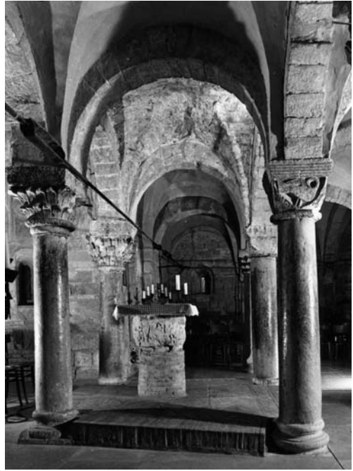
Fig. 9 - Cripta vista interna tirantature metalliche trasversali
