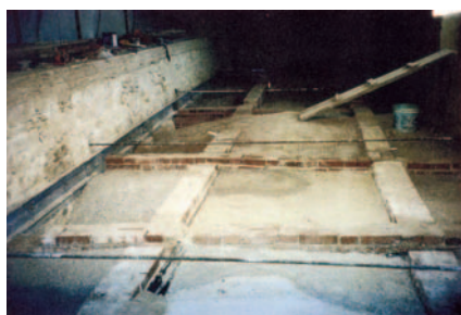
Fig. 6 - La tribuna absidale - Opere di consolidamento e miglioramento sismico, tramite la realizzazione dei frenelli, dei tiranti e collegamento perimetrale fra orizzontamento e strutture murarie verticali.
