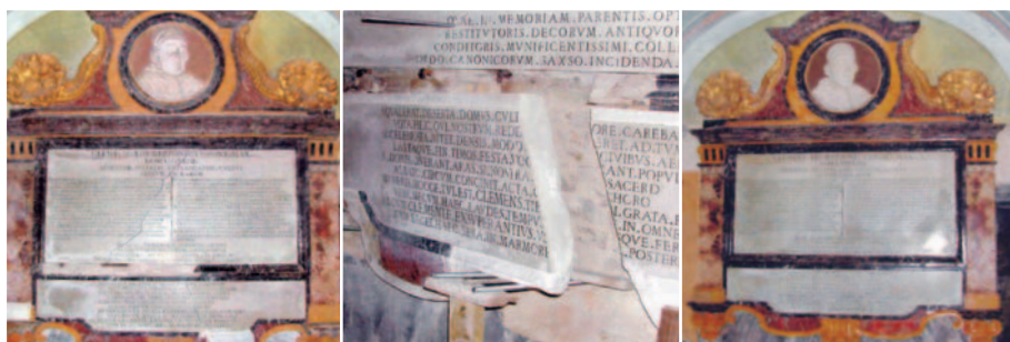
Fig. 11 - Epigrafe nella cripta - Prima dell'intervento di restauro, sono evidenti le lesioni causate dall'ossidazione dei perni di ancoraggio a seguito dell'azione dell'umidità di risalita nelle strutture murarie.
