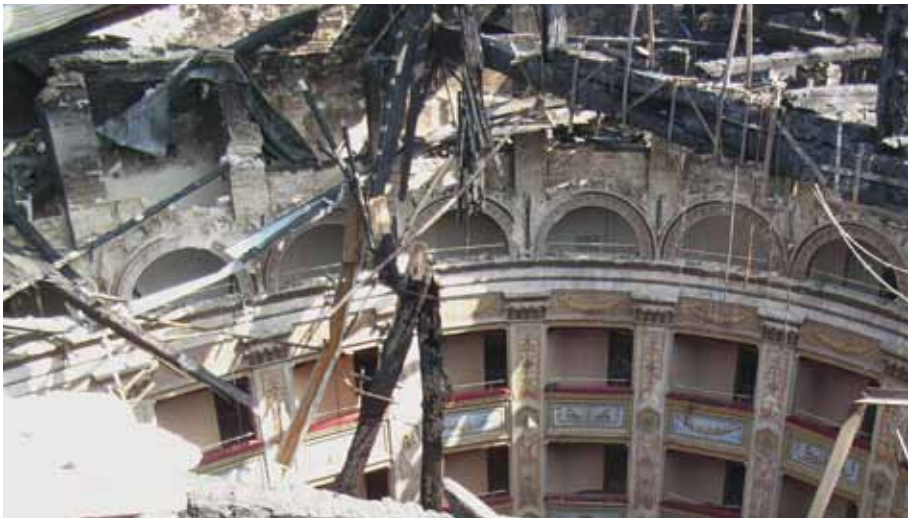
Fig. 2 - Teatro dopo l'incendio
