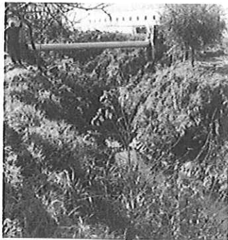
RESTI PONTE FOSSO CASTAGNETO
